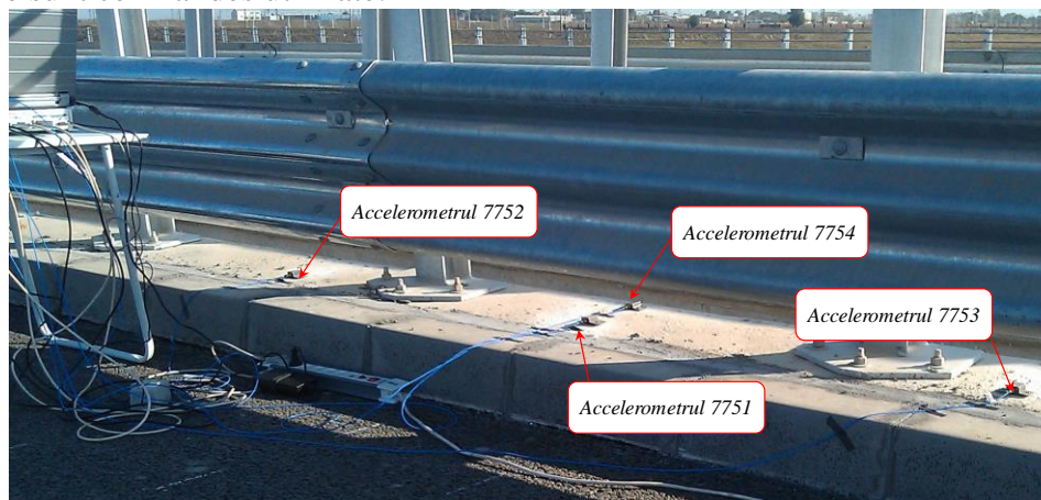
Fig. 10 Lanț de măsură cu accelerometre capacitive
