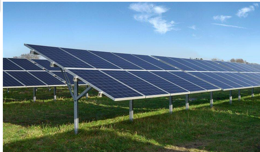
Panouri fotovoltaice Königsolar
