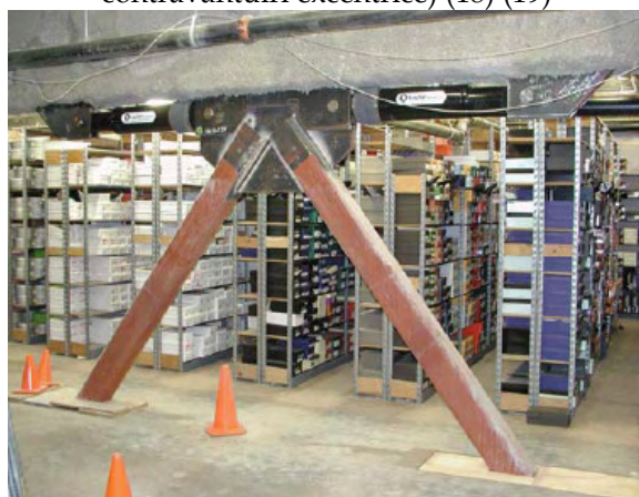
Fig. 2.2.3.1.5 Retail Store, Costa Mesa, CA, SUA (amortizori vâscoși in conclucrare cu diagonale tip chevron) (20)
