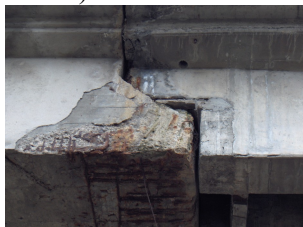
Fig. 1 – Rost de dilatație degradat la pod de beton armat, Buftea
